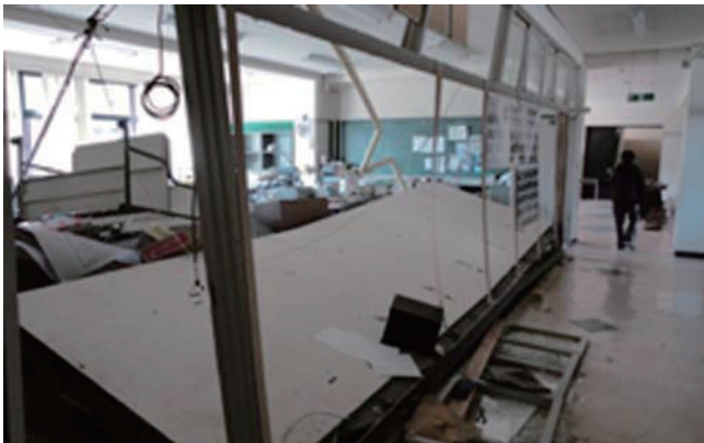
壁が倒壊した東北朝鮮初中級学校の教員室
